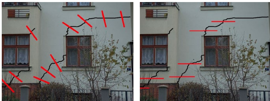
Obr. 51: Trhlina způsobená sednutím, sepnutí trhliny pomocí šikmých nebo ještě lépe horizontálních helikálních výztuže.
