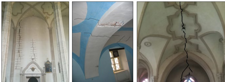
Obr. 23: trhliny způsobené přímým a nepřímým působením břemene v sakrálních stavbách
