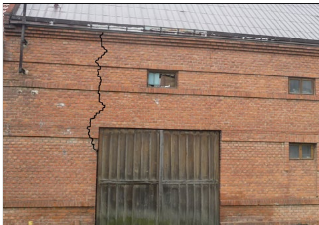
Obr. 70: vertikální trhлина v štítové zdi s danou délkou L = 6 \text{ m}
